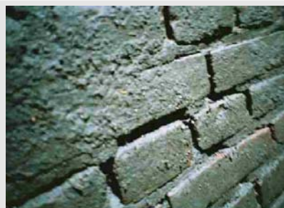
d) Rohrwerkstoff/Kanalzustand: Mauerwerksfugen ausgewaschen
