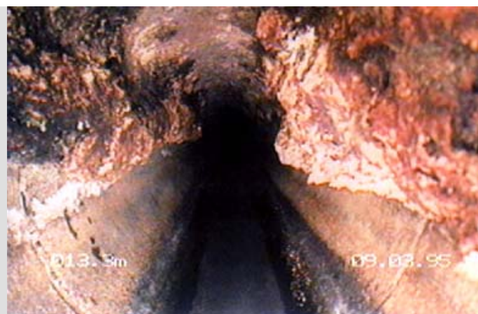
Inkrustation nach erster Reinigung, großflächig
