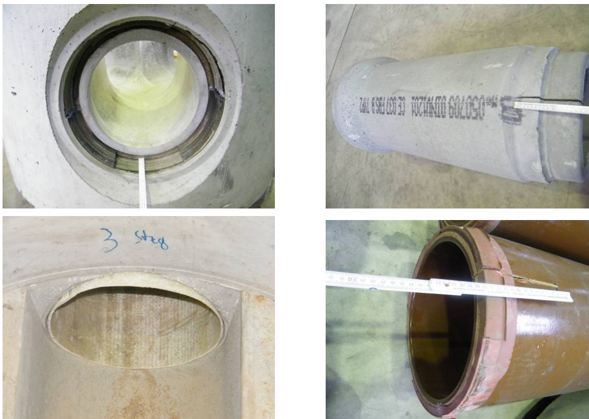
Bild 198 Schäden zur Simulation von Undichtigkeiten an Rohrverbindungen: Geschädigte Dichtung für Betonrohr (oben links); Längsschnitt im Betonrohrscheitel (oben rechts); Eingesetzter Liner mit offenem Ringspalt (unten links); Längsschnitt im Steinzeugrohrscheitel (unten rechts)
