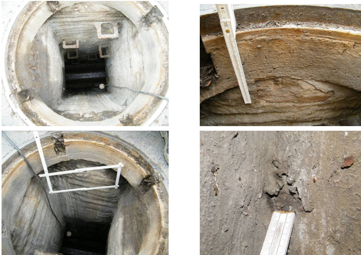
Bild 29 Schacht 3: Blick in den beschichteten Schacht (links oben); Übergangsbereich Schachtrahmen und Beschichtung (rechts oben); Hohlstelle (links unten); Fehlendes Beschichtungsmaterial in einem Eckbereich des Schachtes (rechts unten)
