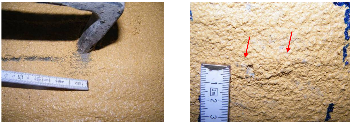
Bild 109 Polyfill-Beschichtung ohne Grundwassereinwirkung: Beispiel für einen unvollständigen Materialauftrag unterhalb einer Steigbügeleinbindung (links) und Riss in der Beschichtung im Bereich einer Hohlstelle aus planmäßiger Verbundschwächung durch Trennmittel FU 2 (rechts)
