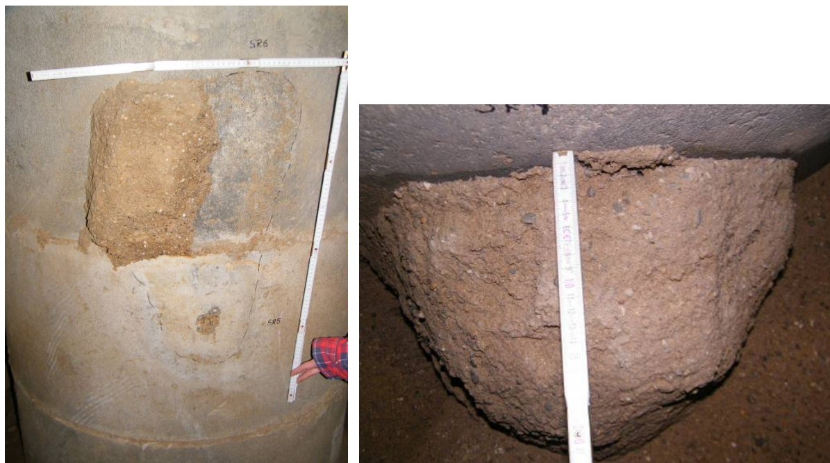
Bild 147 Acrylatgel-Injektionskörper, nur noch im linken Bereich als Teil des Ursprungkörpers anhaftend, Packerloch im unteren Bereich sichtbar (links); weiterer Injektionskörper, noch im unteren Bereich eingeebnet und mit deutlichen Ablösungen im oberen Bereich (rechts)
