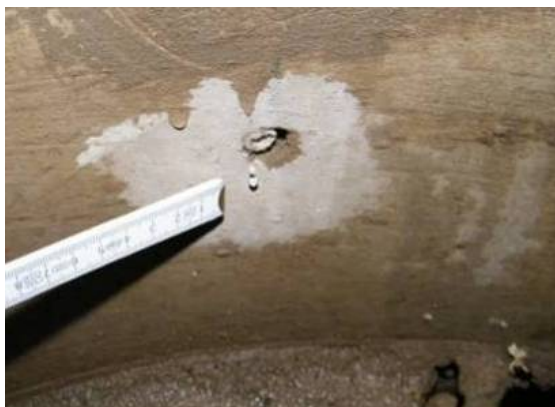
Bild 142 Sanierte Schadstelle LS SU: Nachdrückendes Wasser nach Trocknen dieses Bereichs als Tropfen aus dem Packerloch erkennbar
