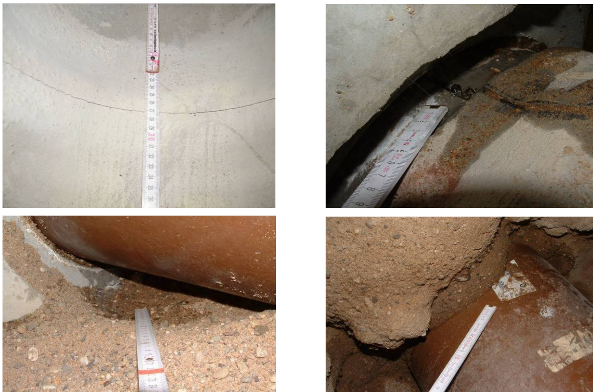
Bild 200 Beispiele für Undichtigkeiten an den Sanierungen bei der ersten Dichtheitsprüfung: Umlaufender Riss im Reparaturmörtel (oben links); Wasser-austritt an mit Epoxidharzmörtel abgedichteter Schadstelle (oben rechts); Undichtigkeit an dauerelastischer Fuge (unten links); Wasser-austritt an mit Polyurethanschaum/-harz abgedichteter Schadstelle (unten rechts)
