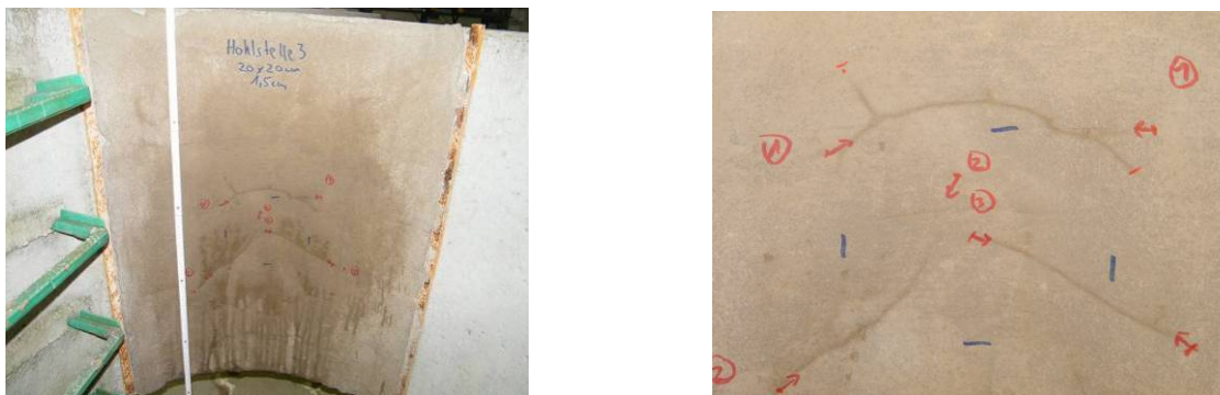
Bild 181 Probekörper H3 nach dem Vornässen und Trocknen: Gesamter Probekörper (links) und Detailansicht Hohlstellenbereich mit erkennbaren Rissen (rechts)
