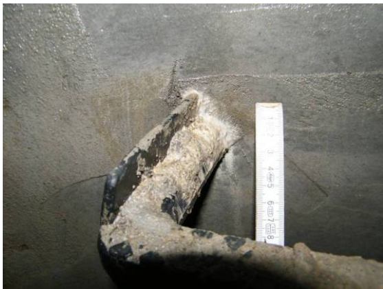
Bild 70 Weiße Ausblühungen an einem Einbindebereich des Steigbügels
