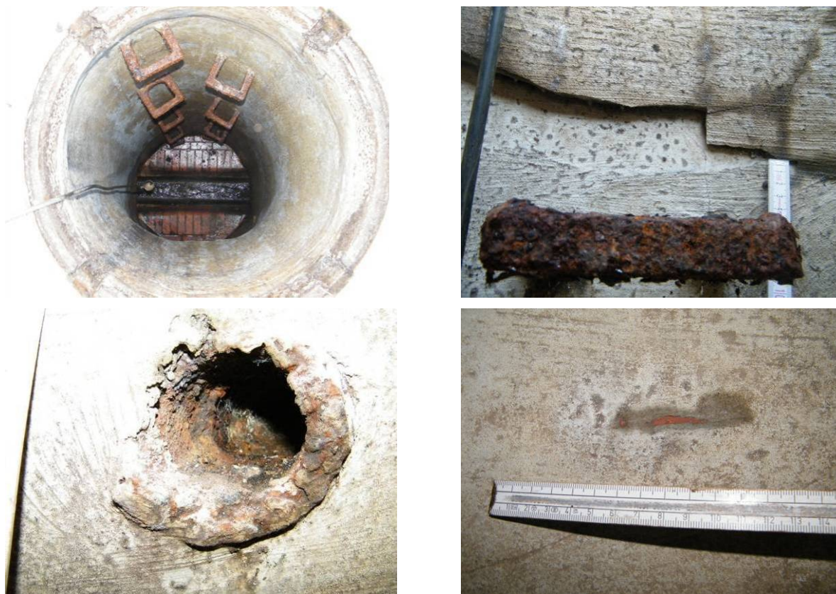
Bild 30 Schacht 4: Blick in den beschichteten Schacht (links oben); schollenartig abgelöste Beschichtung im Bereich des obersten Steigeisens (rechts oben); unverdämmtes Altrrohr (links unten); fehlendes Beschichtungsmaterial (rechts unten)
