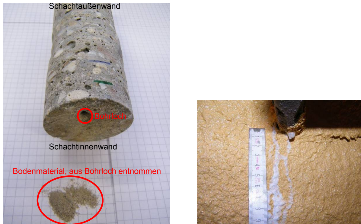
Bild 111 Mit Feinstanteilen aus dem Boden zugesetztes Bohrloch einer Fehlstelle (links), geringfügiger Wassereindrang unterhalb einer Steigbügleinbindung mit weißen Fließspuren (rechts)
