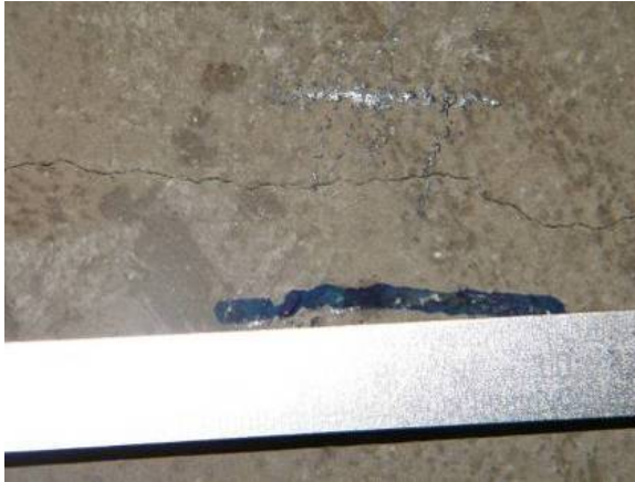
Bild 179 Riss im oberen Hohlstellengrenzbereich von Probekörper H6
