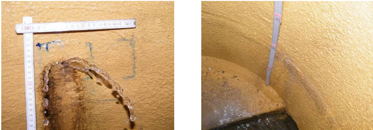
Bild 110 Polyfill-Beschichtung unter Grundwassereinwirkung GW II - Langzeit: Wassereindrang im Bereich einer Hohlstelle aus planmässiger Verbundschwächung durch Trennmittel FU 2 (links), geringfügiger Wassereindrang im Bereich einer vorgeschädigten, reprofilierten Schachtringfuge SF 1 (rechts)
