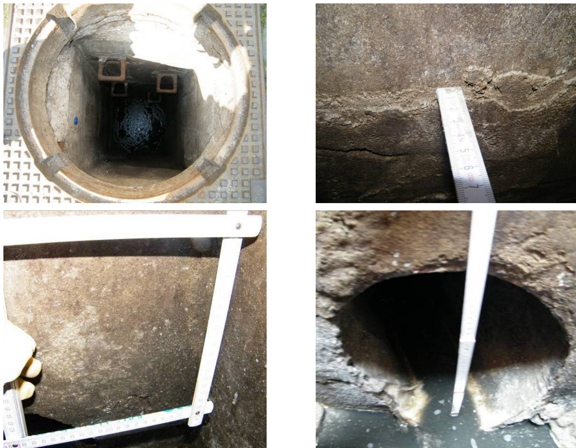
Bild 28 Schacht 2: Blick in den beschichteten Schacht (links oben); Übergangsbereich von Betonwandung und Beschichtung (rechts oben); Hohlstelle (links unten); Beschichtung im Bereich des Ablaufs (rechts unten)
