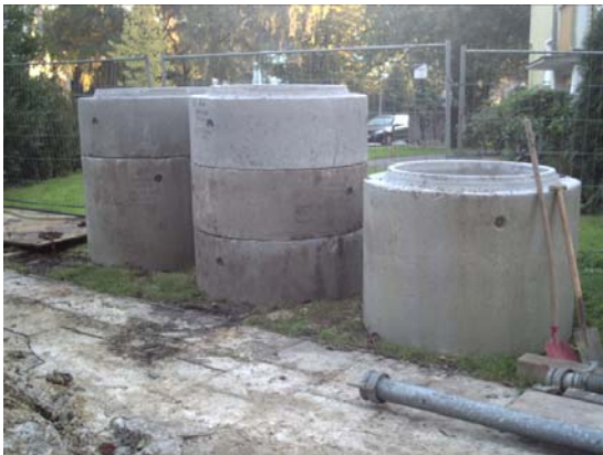
Abb. 18: Nicht normgerechte Lagerung der Schachtbauerteile auf verschmutztem und nassem Untergrund (aus [26])
