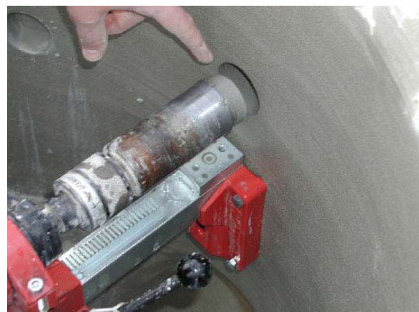
Abb. 137: Ablösung der Beschichtung bei Bohrung zur Vorbereitung der Haftzugprüfungen
