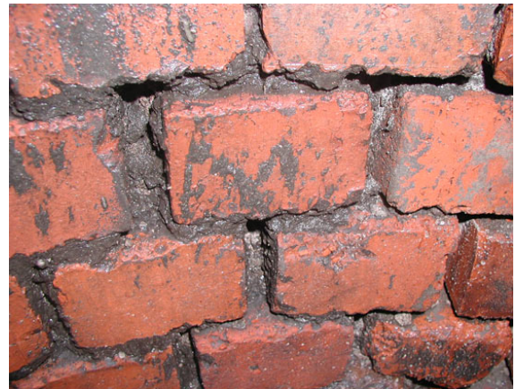
Abb. 56: Tief korrodierte Fugen in einem Mauerwerksschacht
