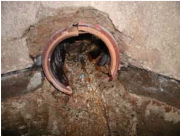
Abb. 53: Nachträglich eingebundener Zulauf in einem Schacht aus Betonfertigteilen
