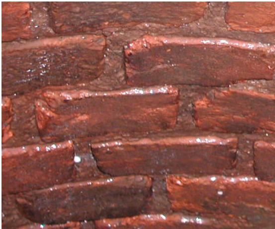
Abb. 65: Flächig feuchte Wandung mit ablaufendem Wasser in einem Schacht aus Mauerwerk
