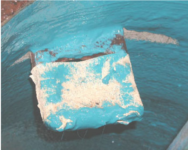
Abb. 86: Spritzschattenbildung neben einem Steigeisen bei einer Polyurethanbeschichtung im Sprüh- Schleuderverfahren
