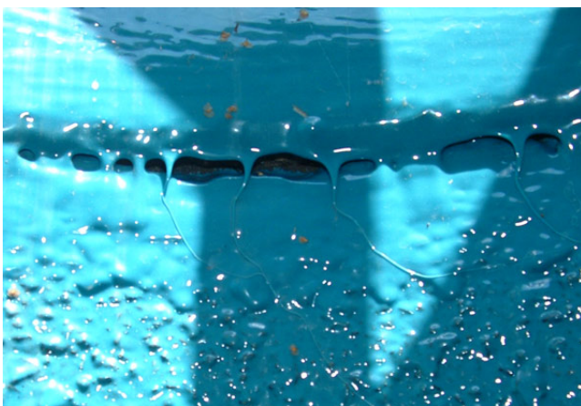
Abb. 114: Nicht komplett verschlossener Spalt unterhalb des Konus von Schacht Nr. 39
