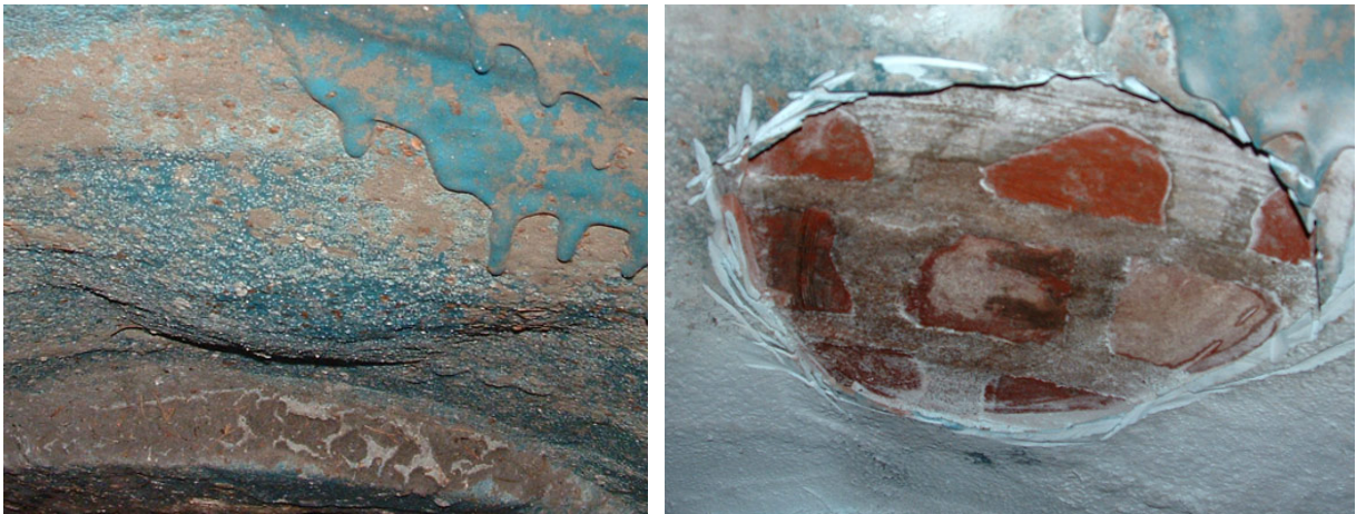
A B Abb. 113: Wassergefüllte Blase in einer Polyurethanbeschichtung auf Mauerwerk. A: Ansicht bei der zweiten Nachuntersuchung nach 6 Monaten. B: Ansicht nach Aufschneiden der Blase.
