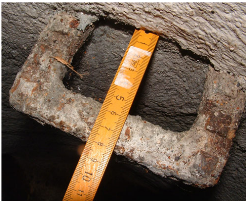
Abb. 98: Zu geringe Auftrittstiefe an einem Steig Eisen, das vor der Beschichtungsmaßnahme nicht abmontiert worden war
