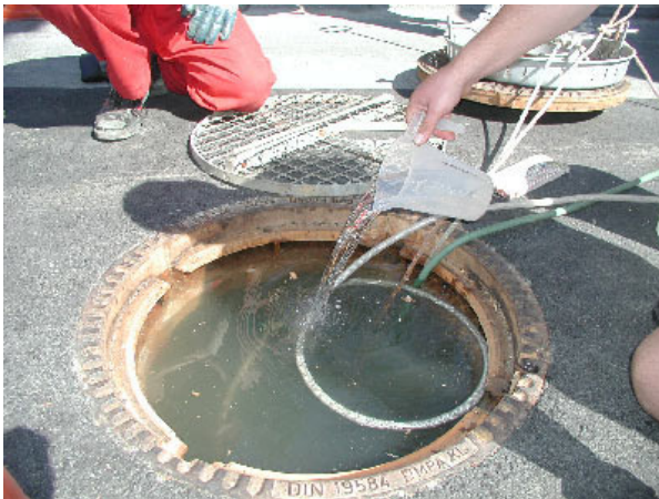
Abb. 16: Dichtheitsprüfung mit Wasser nach DIN EN 1610 an einem in Betrieb befindlichen Schacht
