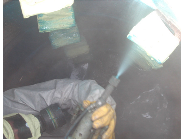
Abb. 87: Polyurethanauftrag im Anspritzverfahren im Bereich der Steigeisen vor der Beschichtung im Sprüh- Schleuderverfahren
