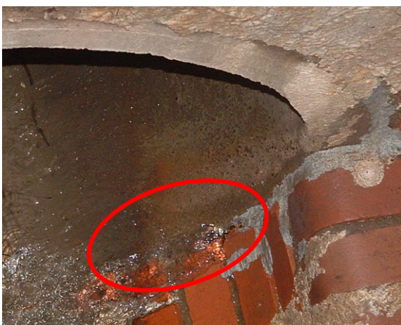
Abb. 51: Undichtigkeit im Gerinne im Bereich der Einbindung des Ablaufes
