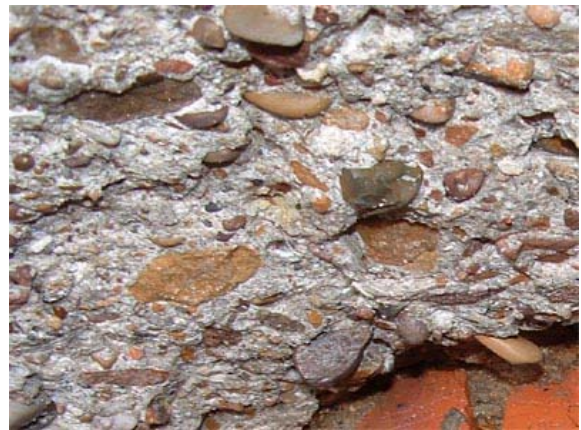
Abb. 69: Korrodierte Schachtwandung aus Beton
