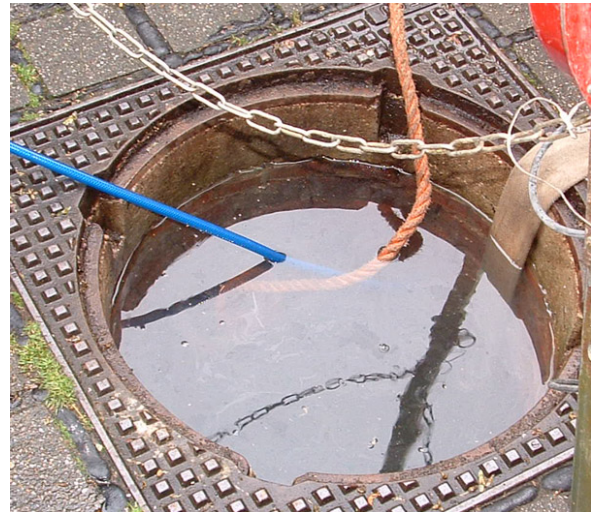
Abb. 50: Füllen des Schachtes bis zu den Auflagerungen für eine Prüfung gemäß DIN EN 1610
