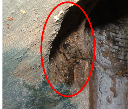
Abb. 104: Nicht beschichtete Stelle im Bereich eines Zulaufs
