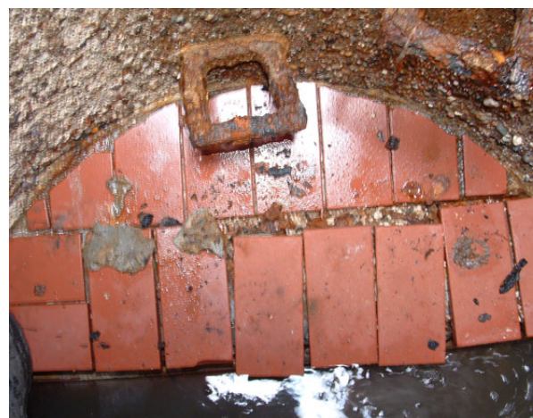
Abb. 52: Sanierungsbedürftige Berme in einem Schacht aus Betonfertigteilen mit dem Schadensbild Korrosion
