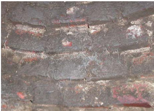
Abb. 68: Starke Schmutzablagerungen an der Mauerwerkswandung des Schachtes Nr. 26
