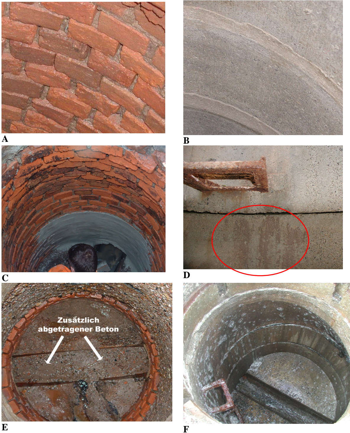
Abb. 72: Schachtreinigung mit Wasserhochdruck. A: Saubere Mauerwerkswandung. B: Saubere Betonwandung. C: Schwarze Beläge und Rückstände auf Mauerwerkswandungen nach Reinigung. D: Schmutzrückstände auf Betonwandung nach Reinigung. E: Abgetragener Beton nach zusätzlicher Reinigung mit rotierender Schachtreinigungsdüse. F: Auf die Schachtwandung aufgetragenes fettlösendes Reinigungsmittel.
