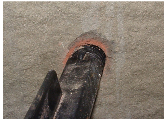
Abb. 99: Abplatzungen in der Mörtelbeschichtung bei einem nachträglich angebrachten Steigbügel
