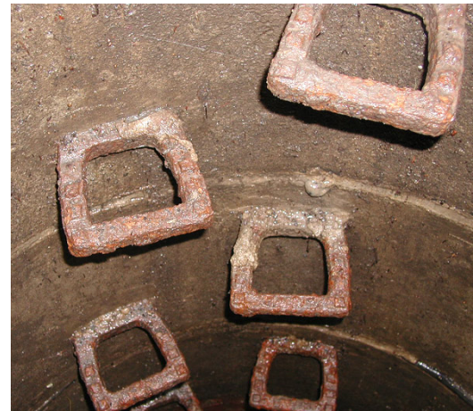
Abb. 8: Zweiläufiger Steigeisengang in einem Schacht aus Betonfertigteilen
