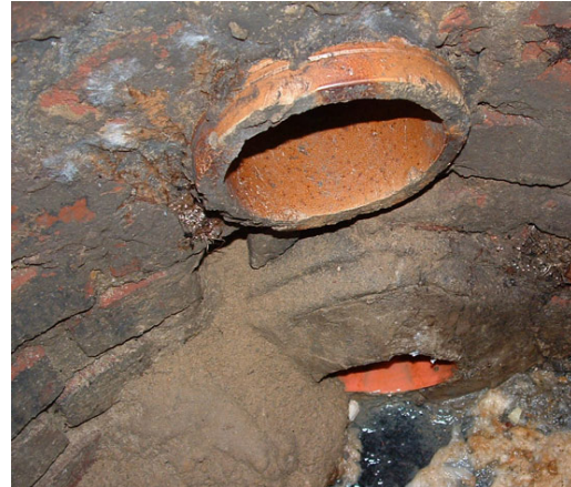
Abb. 54: Nachträglich eingebundener Zulauf in einem Schacht aus Mauerwerk, Bodeneintrag durch fehlende Klinker in der Schachtwandung
