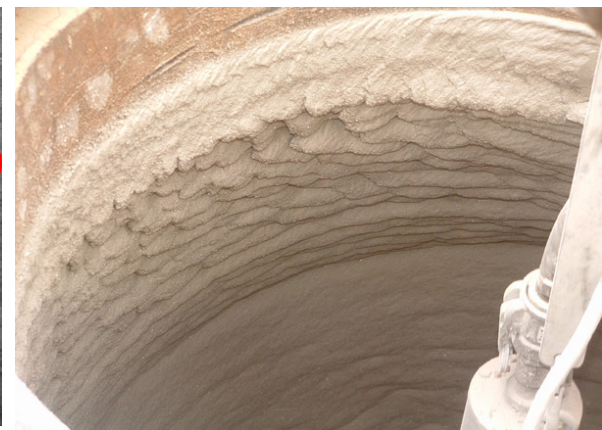
Abb. 81: Wellenartige Oberflächenstruktur einer Mörtelbeschichtung durch mehrfaches Abrutschen des Zugseils während des Anschleudervorgangs
