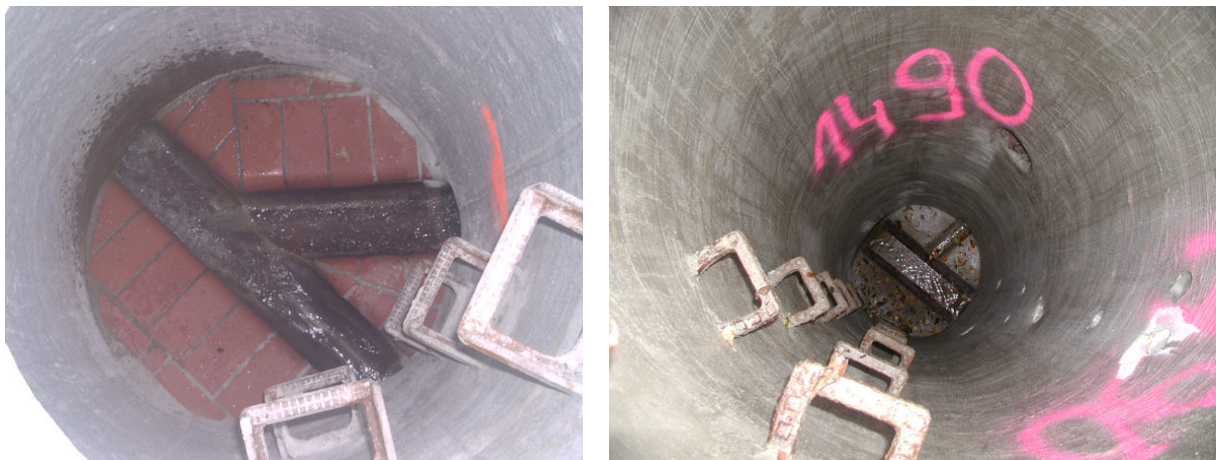
Abb. 94: Beispiele für Mörtelbeschichtungen ohne sichtbare Mängel
