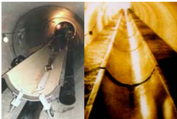
Ausschnitt aus dem 200 m langen Rinnen-Wärmetauscher vor und nach dem Eingiessen in die bestehende Kanalisation
