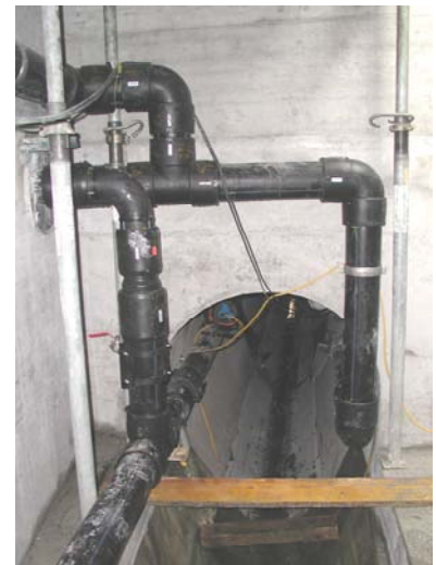
Zu- und Ableitung von Vor- und Rücklaufleitungen
