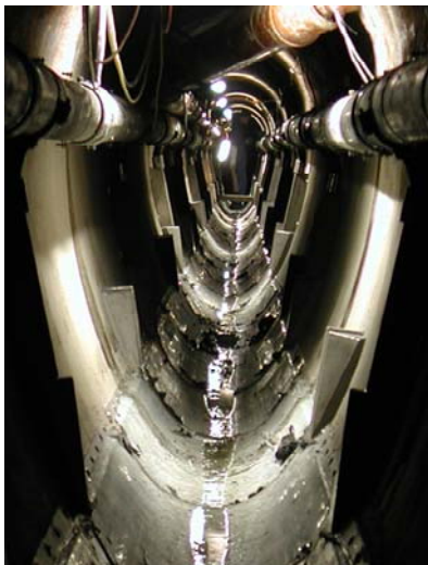
Wärmetauscher mit Verbindungskupplungen, Anschlüssen sowie Vor-/Rücklaufleitungen
