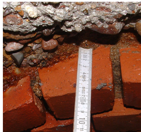
Abb. 7: Starker Abtrag durch Korrosion in einem Schacht mit Mauerwerksunter- teil und aufgesetzten Betonfertigteilen
