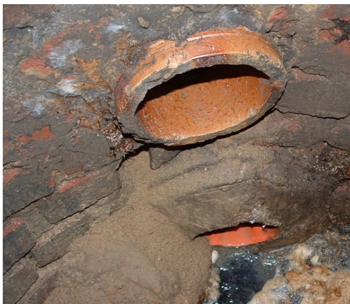
Abb. 6: Nachträglich eingebundener Zu- lauf in einem Schacht aus Mauer- werk, Bodeneintrag durch fehlende Klinker in der Schachtwandung
