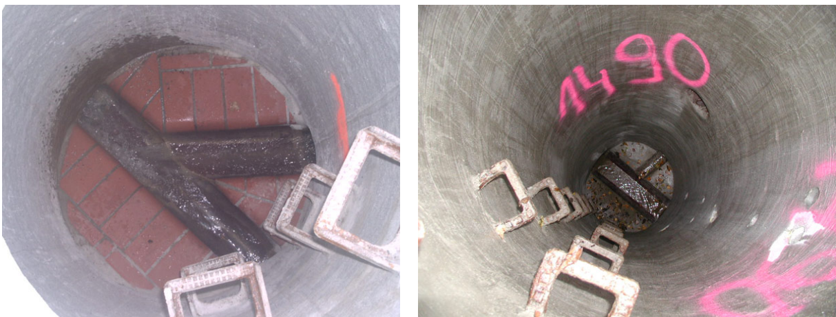
Abb. 10: Beispiele für Mörtelbeschichtungen ohne sichtbare Mängel
